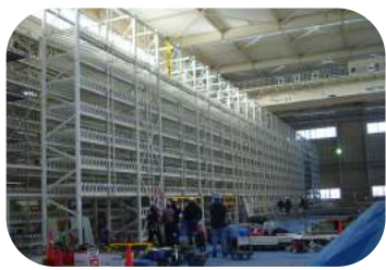
立体自動倉庫 2
