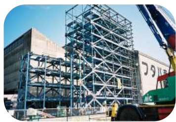
立体自動倉庫
